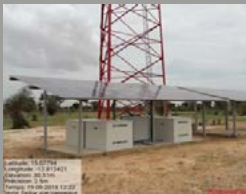
Site solaire classique
