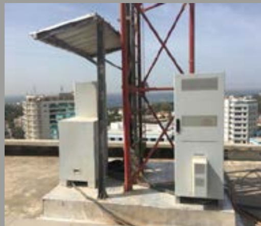
Site outdoor avec Batteries au Lithium
